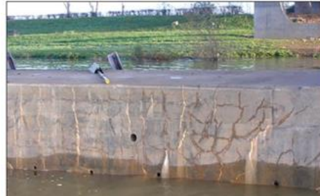
(a) fissuras na base de uma ponte, com espessura superior a 0,3mm
