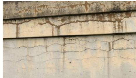
(b) Fissuras em viga de concreto pré-moldado
